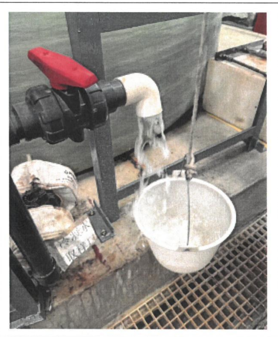
图 9.4 钴车间处理设施（中和、压滤）处理后采样口 ★W4
