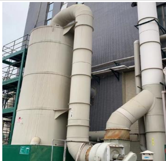
复分解反应工序废气治理措施（TA01 碱液喷淋塔）
