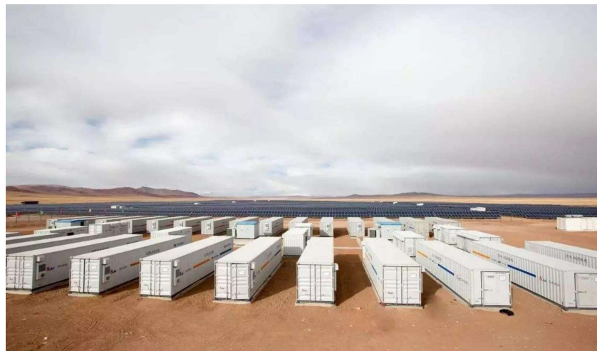
嘉峪关正泰二期70兆瓦光储一体化发电项目
