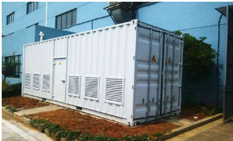
创源动力1MWh储能系统
