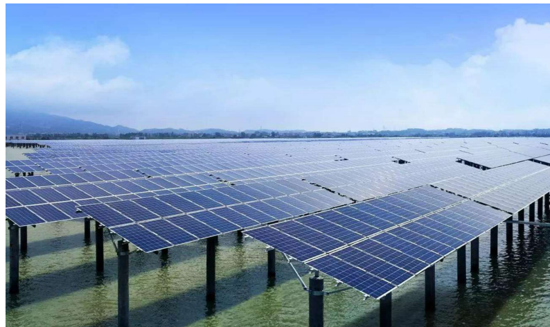
温州泰瀚550MW渔光互补光伏发电项目
