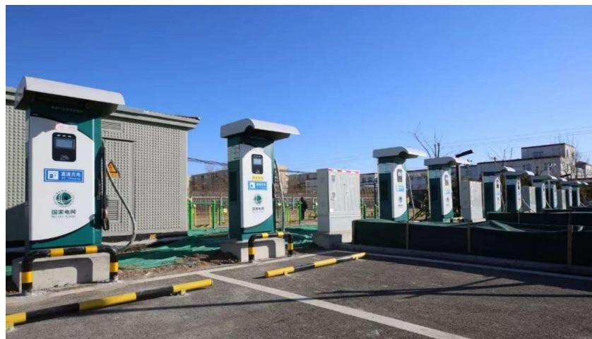
南京公交一期36座充电站 (262充电桩)
